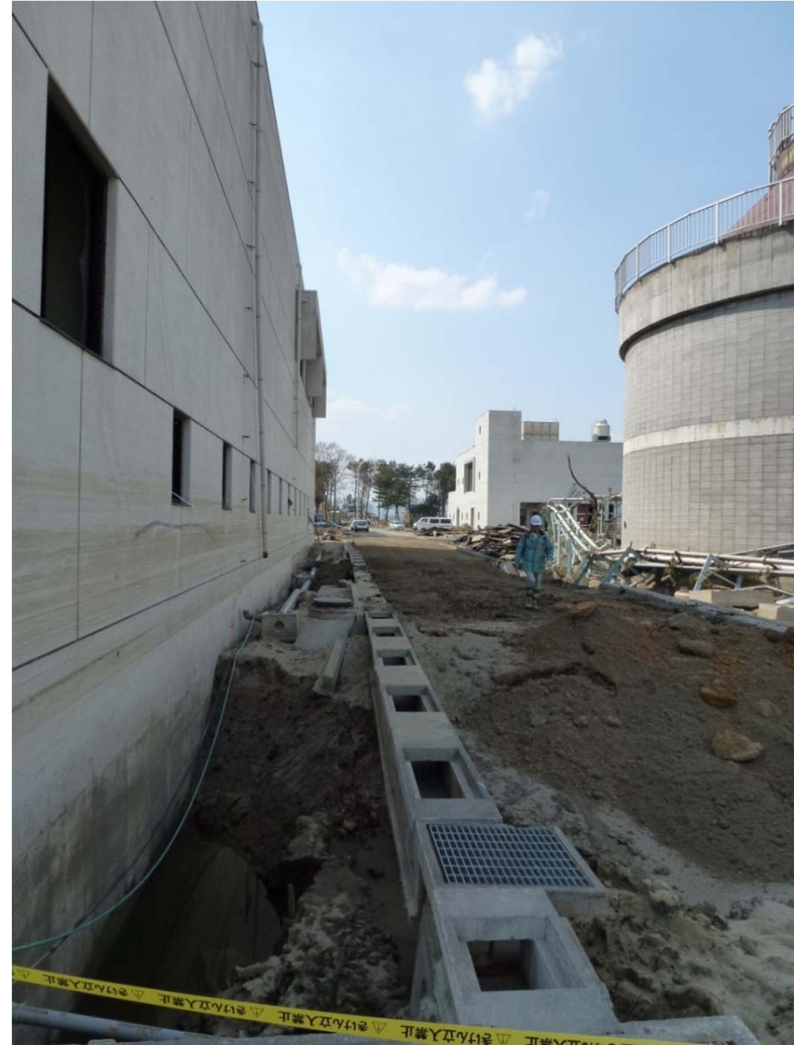
(県南浄化センター)
