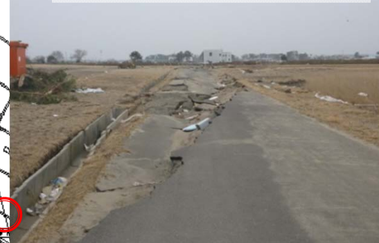
場周道路陥没（北側を望む）
