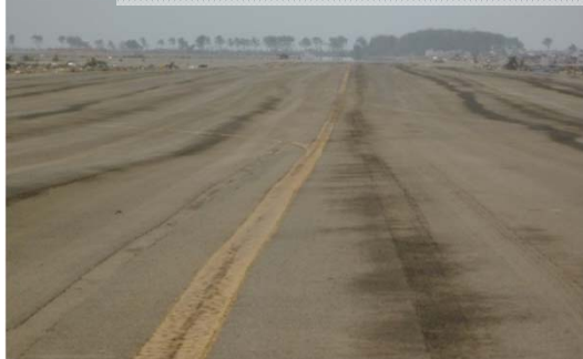
木引堀西側（未施工エリア） に陥没あり（東側を望む）
